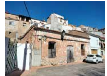
12. TINTES TEXTILES: Edificio en desuso y desmantelado.
