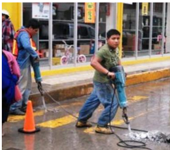
Foto 1. Trabajadores sin protección adecuada
